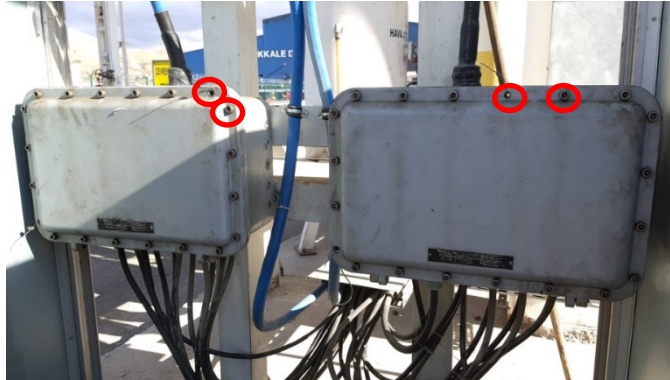
Şekil 3 Elektrik Terminal Kutuları
