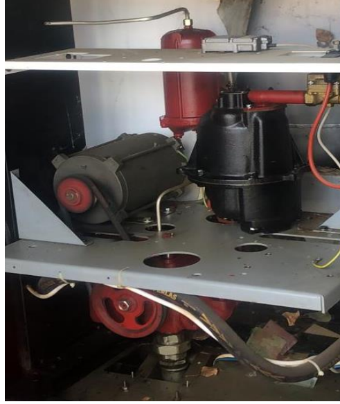
Şekil 2 Brodimetre, Pulser, Emişli Pompa, Hava Ayırıcısı Grubu
